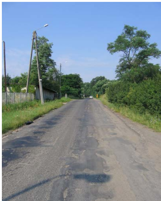
Fot. nr 33. Grabowno Wielkie – droga asfaltowa w złym stanie technicznym.
