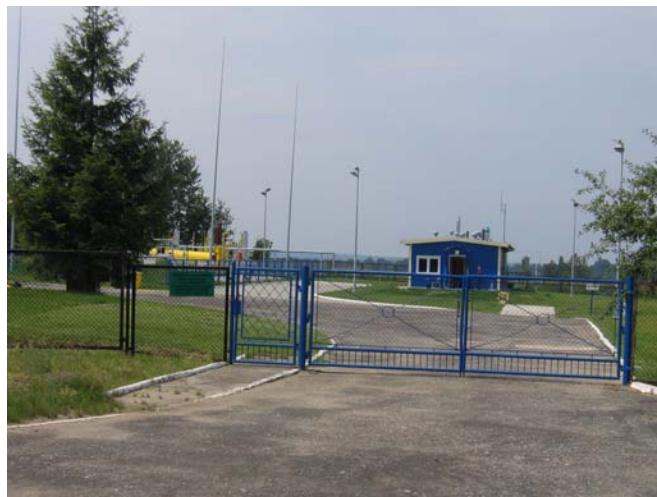
Fot. nr 27. Stacja redukcyjna na terenie kopalni Brzostowo.
