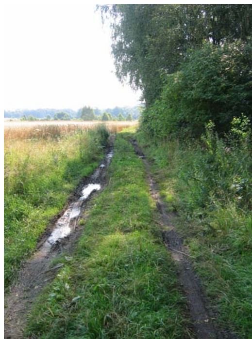
Fot. nr 32. Grabowno Wielkie – droga gruntowa w złym stanie technicznym.
