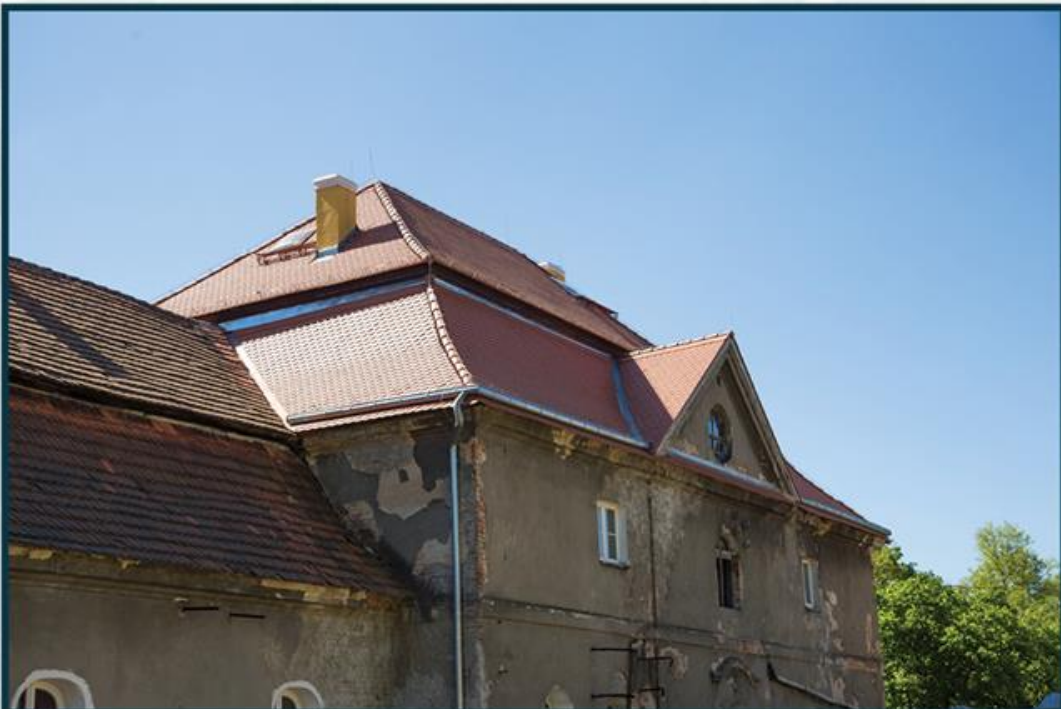
Remont dachu budynku nr 7 w zespole pałacowo-parkowym w Goszczu wartość: 378 815,42 zł dofinansowanie: 108 807,64 zł
