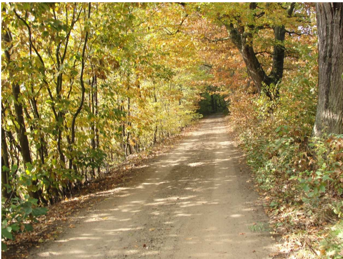
Stan istniejący nawierzchni drogi gminnej120304D
