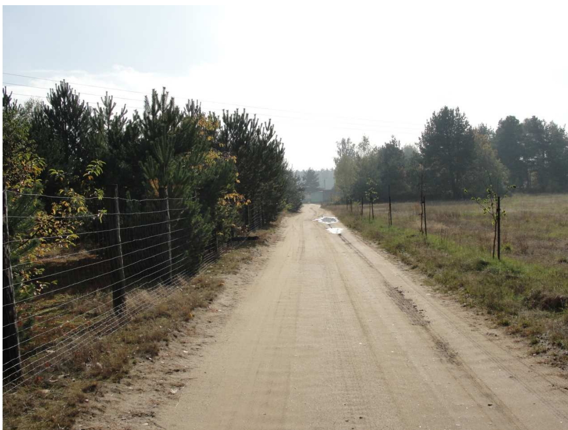
Stan istniejący nawierzchni drogi gminnej 120304D
