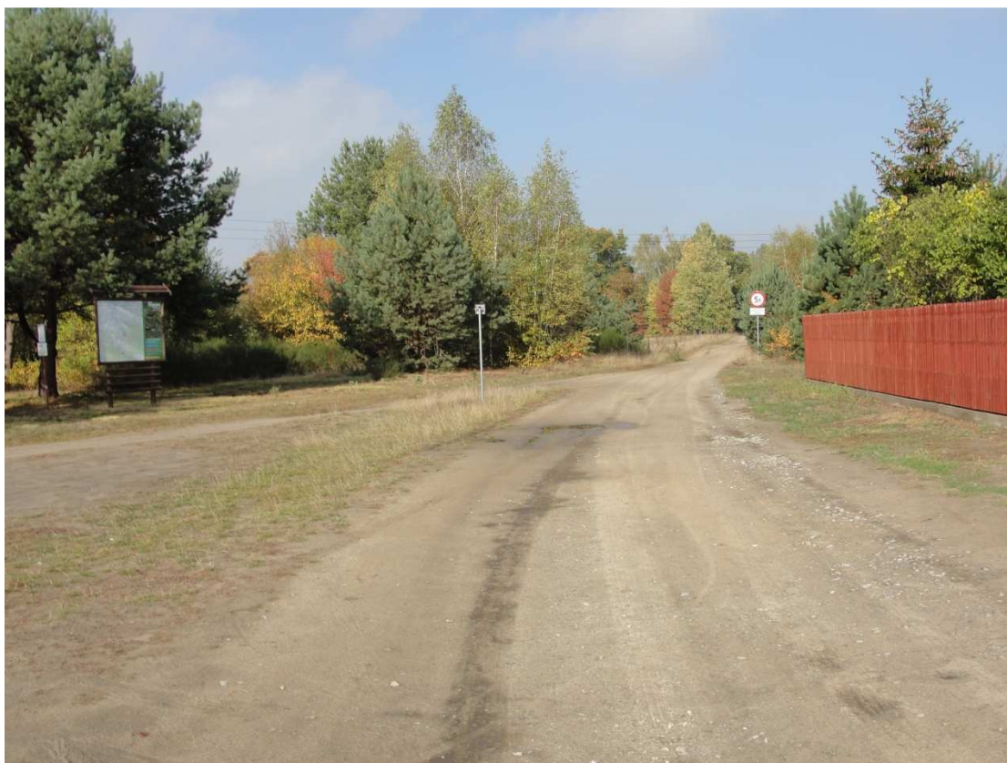
Stan istniejący nawierzchni drogi gminnej 120304D
