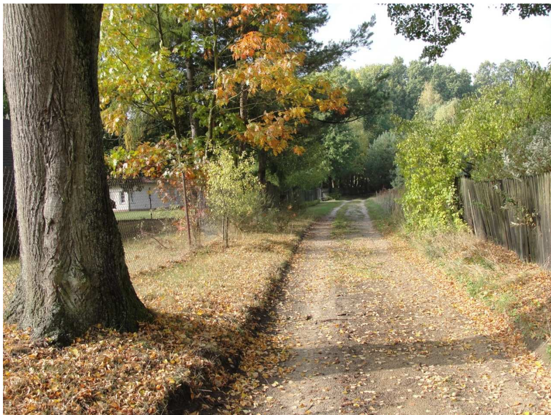
Stan istniejący nawierzchni drogi gminnej120304D
