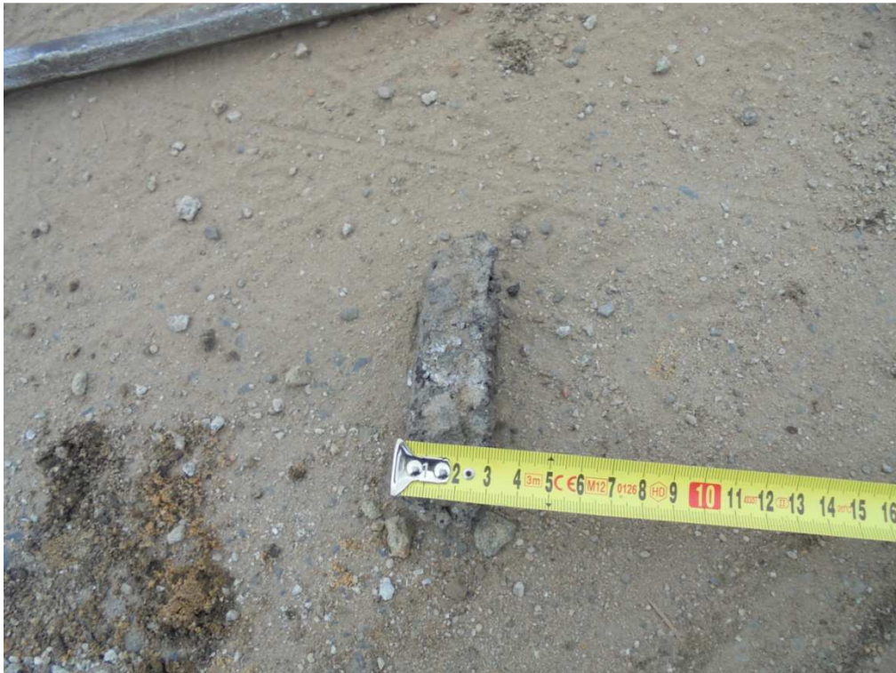
Odwiert nr 5 - ul. Rynek 3cm nawierzchnia bitumiczna, 5cm tłuczeń kamienny, 15cm kostka klinowana grunty piaszczyste z lokalnymi przewarstwieniami pasków pylastych
