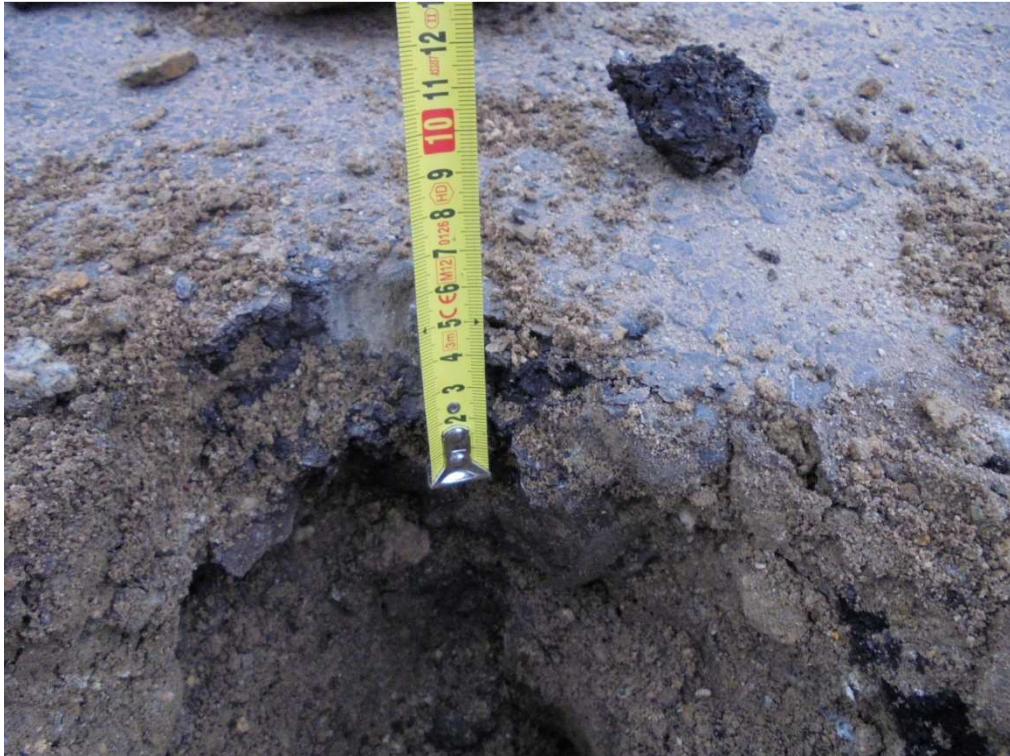
Odwiert nr 7 - ul. Rynek od strony DW Nr 448 4 cm nawierzchnia bitumiczna, 10cm piasek/drobny granit, grunty piaszczyste z lokalnymi przewarstwieniami pasków pylastych
