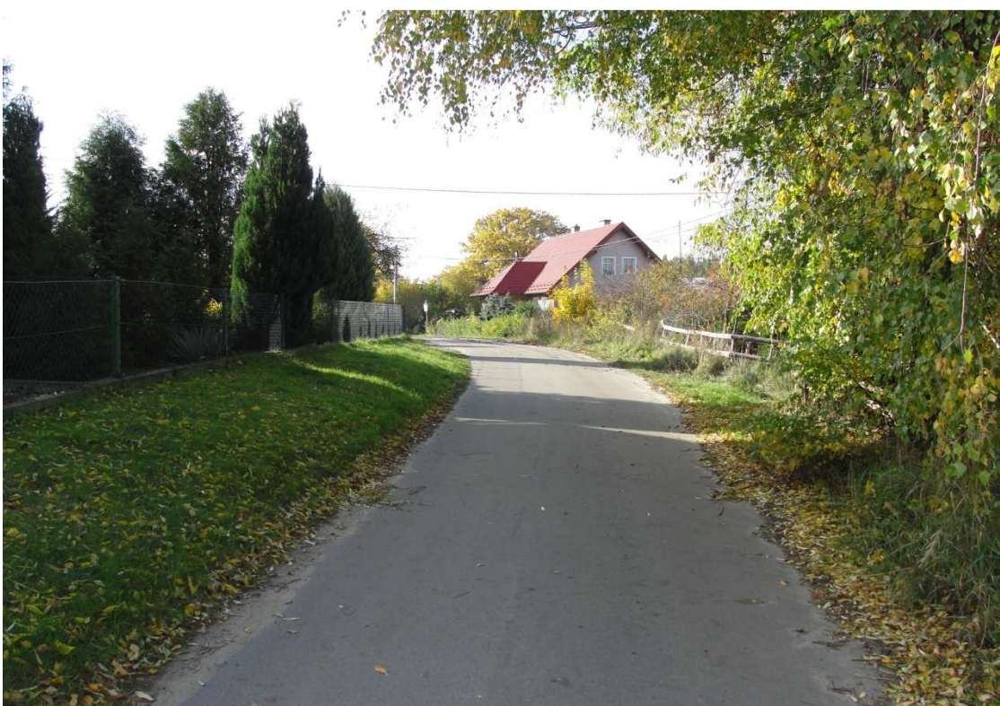
Stan istniejący nawierzchni drogi gminnej 101953D
