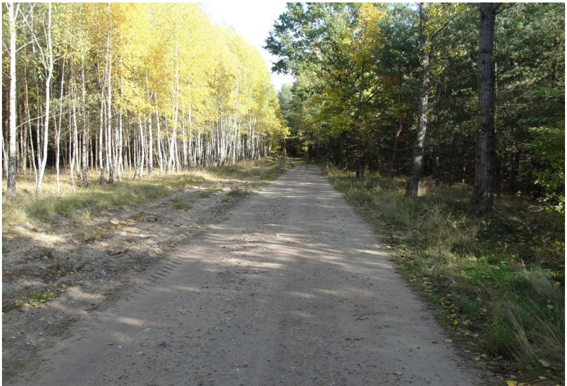
Stan istniejący nawierzchni drogi gminnej 101953D
