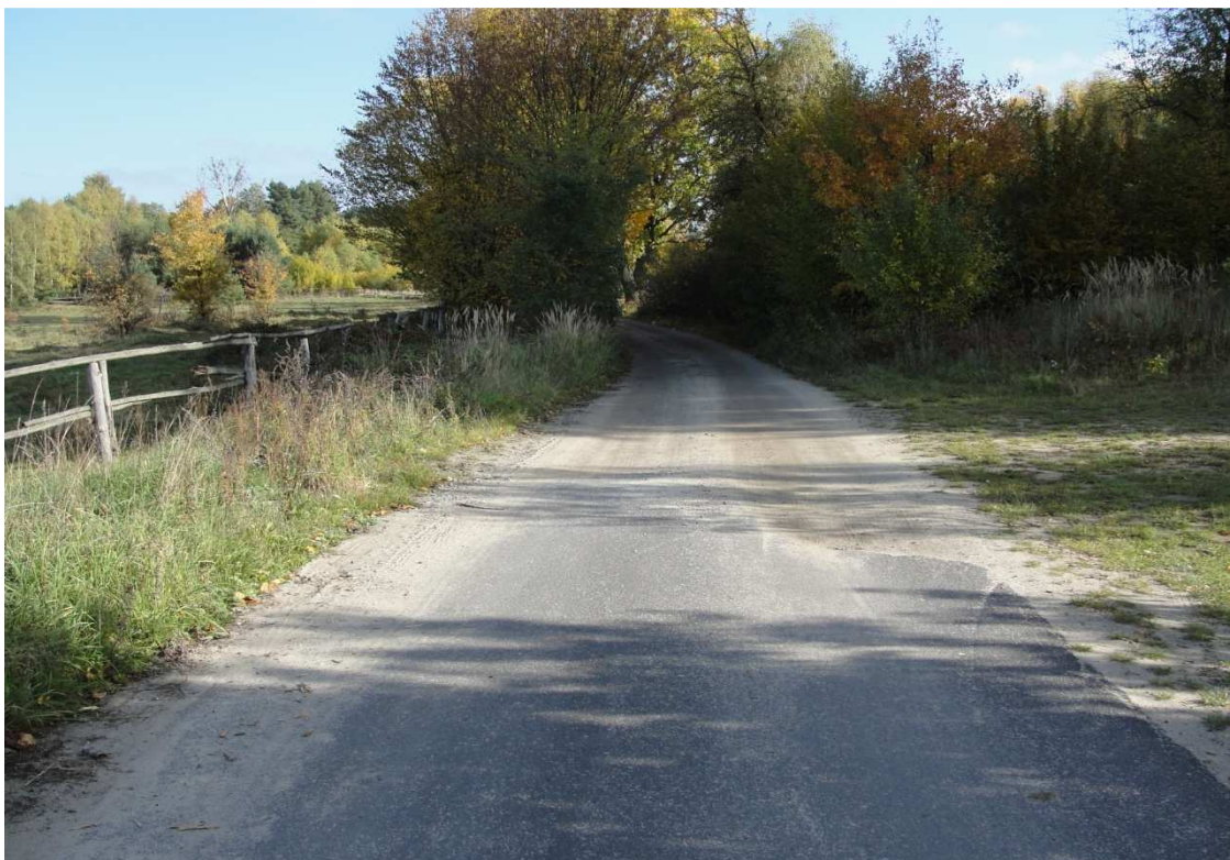
Stan istniejący nawierzchni drogi gminnej 101953D
