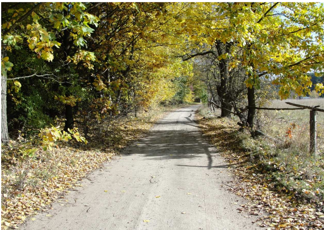
Stan istniejący nawierzchni drogi gminnej 101953D
