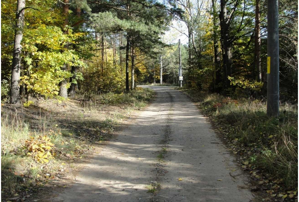
Stan istniejący nawierzchni drogi gminnej 101953D
