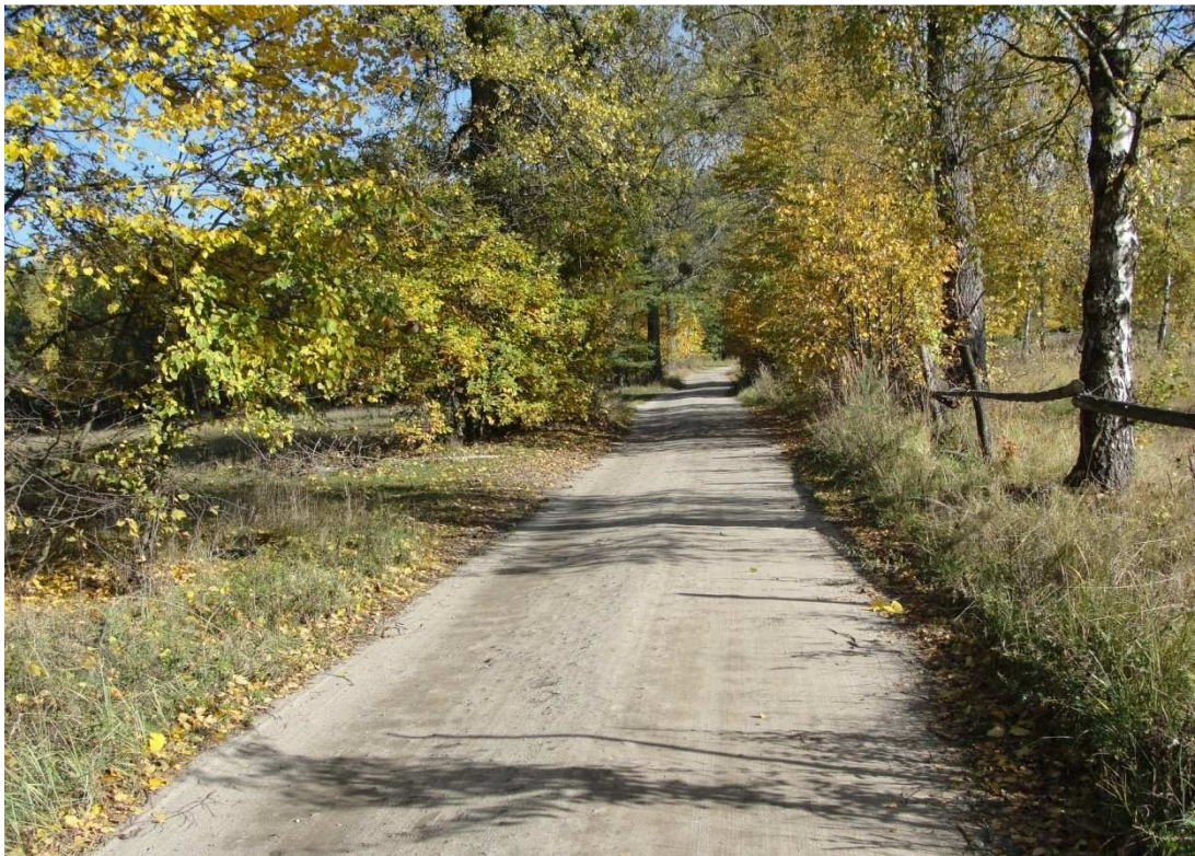
Stan istniejący nawierzchni drogi gminnej 101953D
