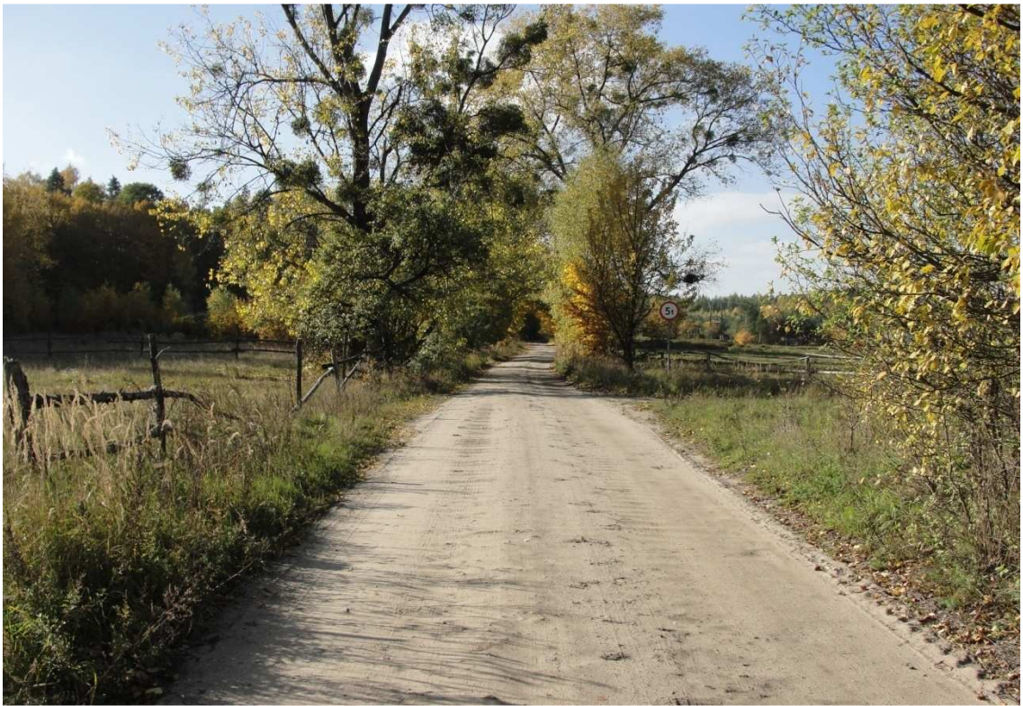
Stan istniejący nawierzchni drogi gminnej 101953D
