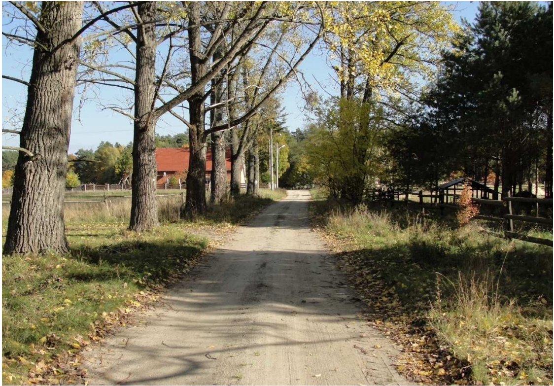
Stan istniejący nawierzchni drogi gminnej 101953D
