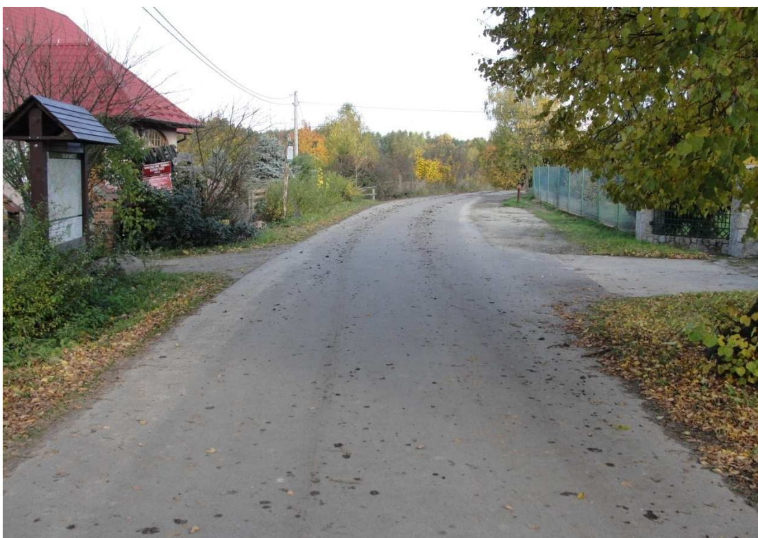
Stan istniejący nawierzchni drogi gminnej 101953D
