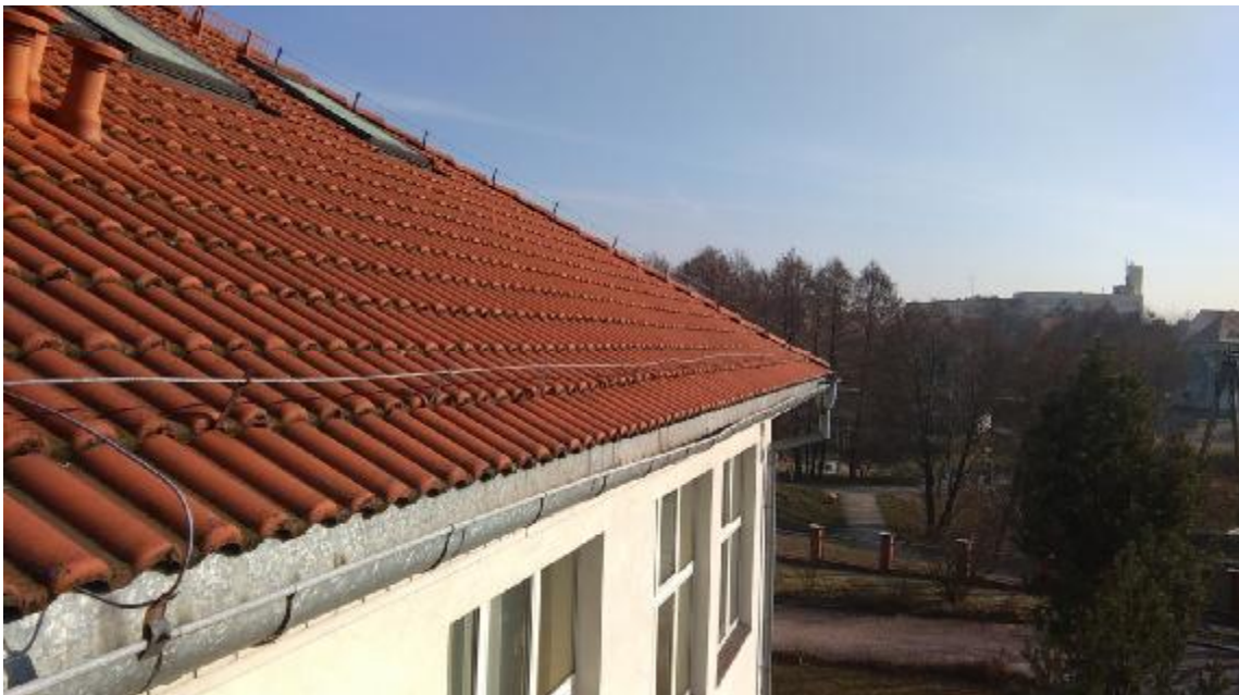
Wygięta rynna dachowa –brak płotków
