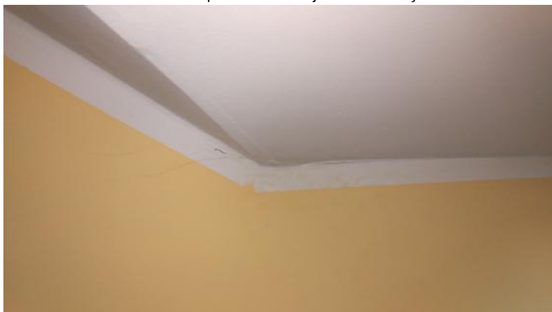
Zniszczenia pomieszczeń w miejscach zlewni koszy
