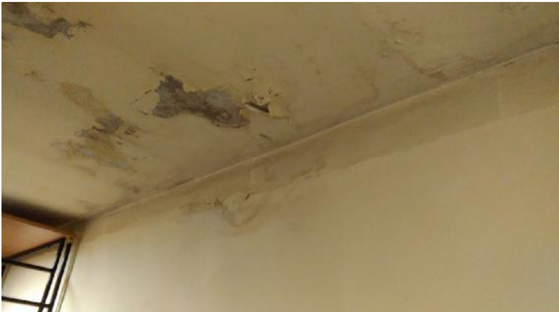
Zalane pomieszczenie piwnicy ( brak rynny nad wejściem głównym )
