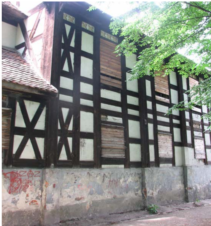
Zdj. Nr 1 - Ceglany cokół, fragmenty opaski betonowej i widok ściany bocznej muru pruskiego
