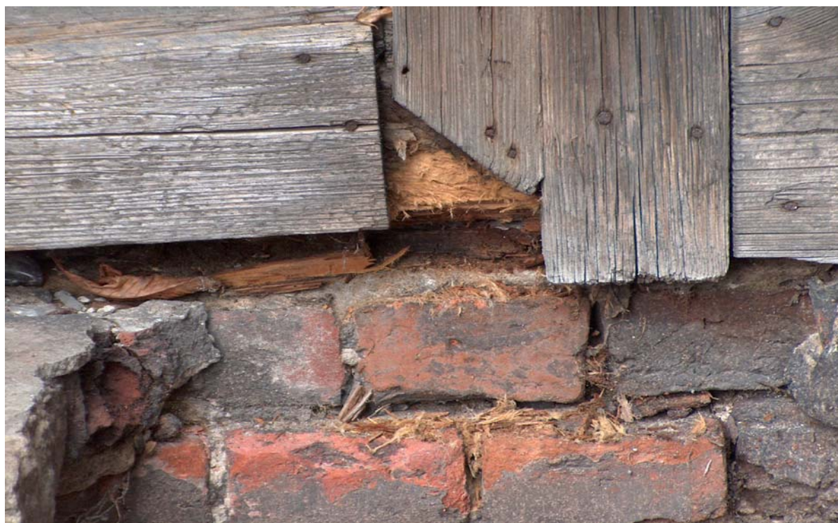
Zdjęcie Nr 4 – widoczne porażenie elementów drewnianych oraz brak tynku na podmurówce.
