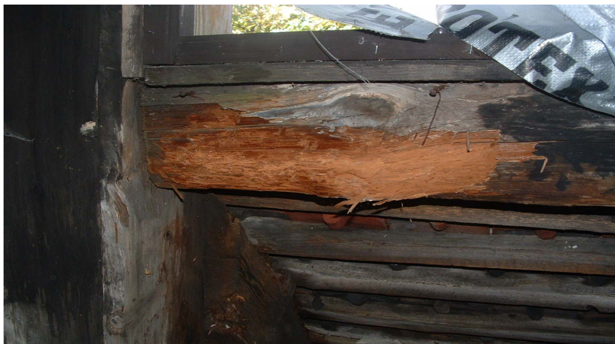
Zdjęcie 18 – konstrukcja porażona grzybem
