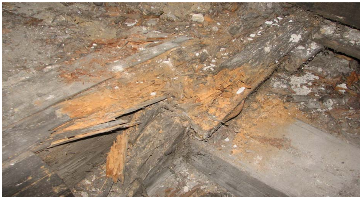
Zdjęcie 15 – Porażona belka stropowa przy schodach prowadzących na poddasze.
