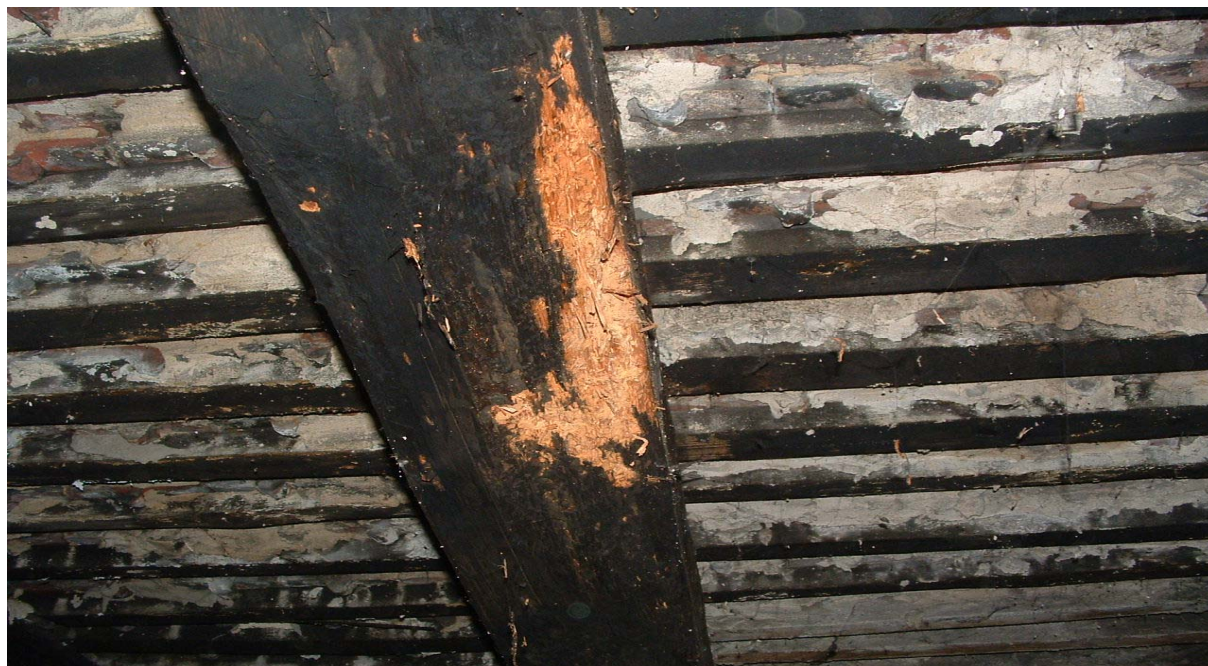
Zdjęcie nr 11 – porażona krokiew oraz zaprawa uszczelniająca dachówkę.
