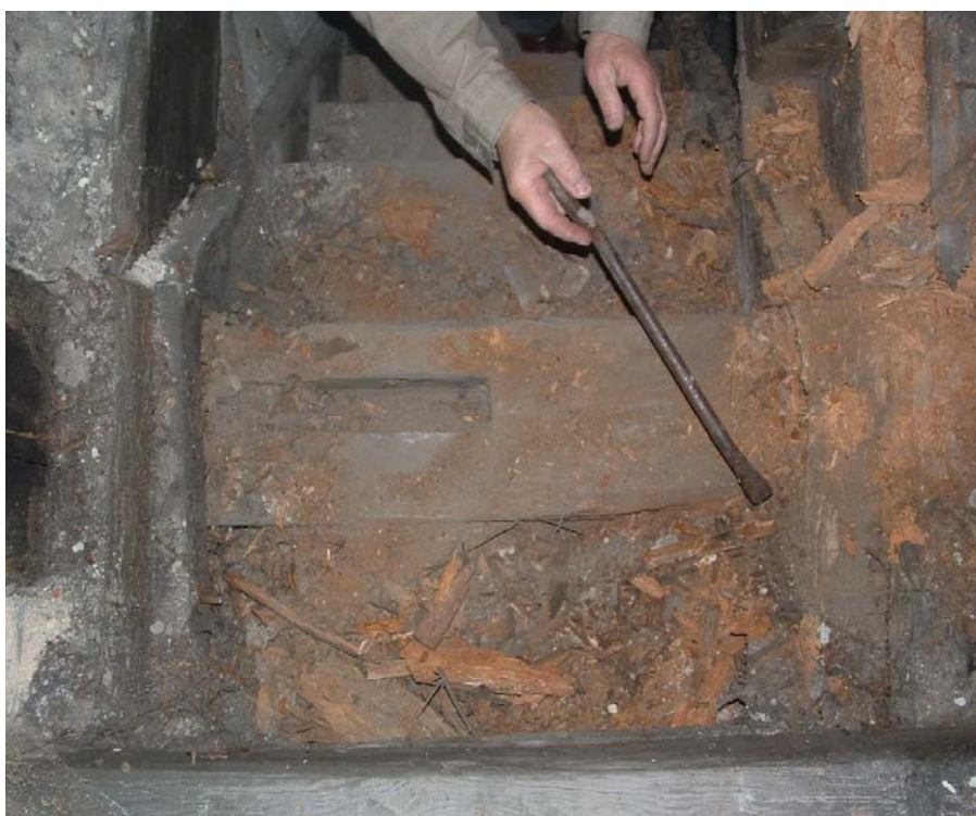
Zdjęcie Nr 10 – korozja biologiczna belki stropowej w obrębie wieży dzwonnicy
