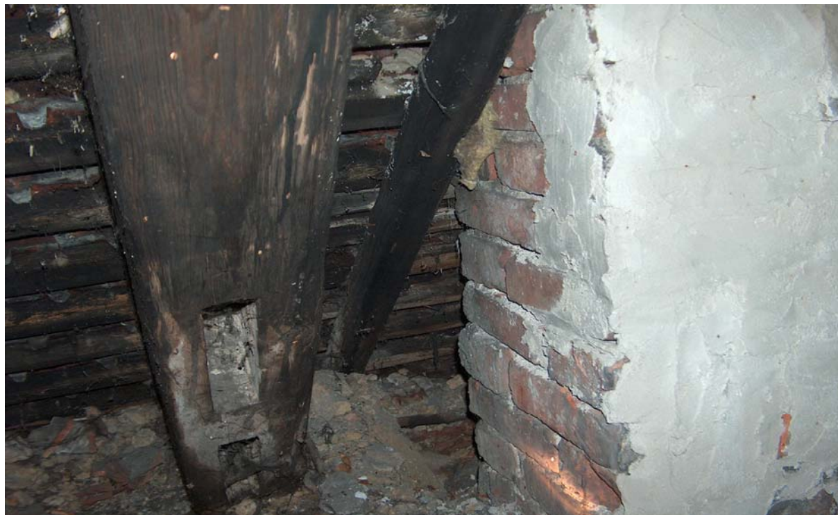
Zdjęcie Nr 12 – nieotynkowany pion komina oraz wycięcia w belce krokwi.
