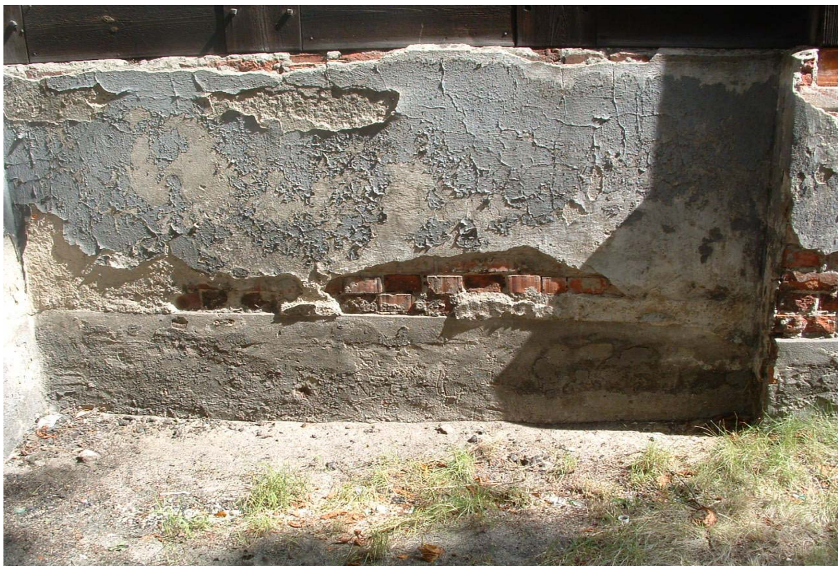
Zdjęcie Nr 3 – Ceglana podmurówka. Widoczne ślady erozji cegieł i tynku.
