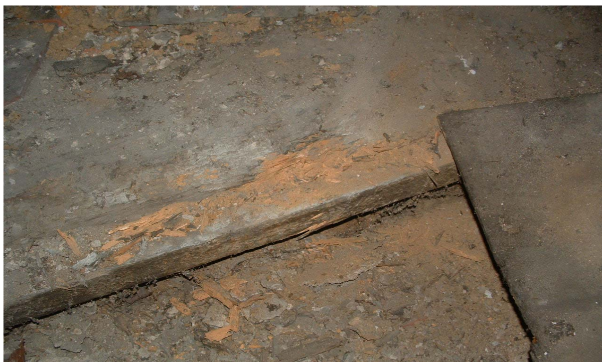
Zdjęcie 14 – fragment odkrywki ukazujący korozję biologiczną stropu.
