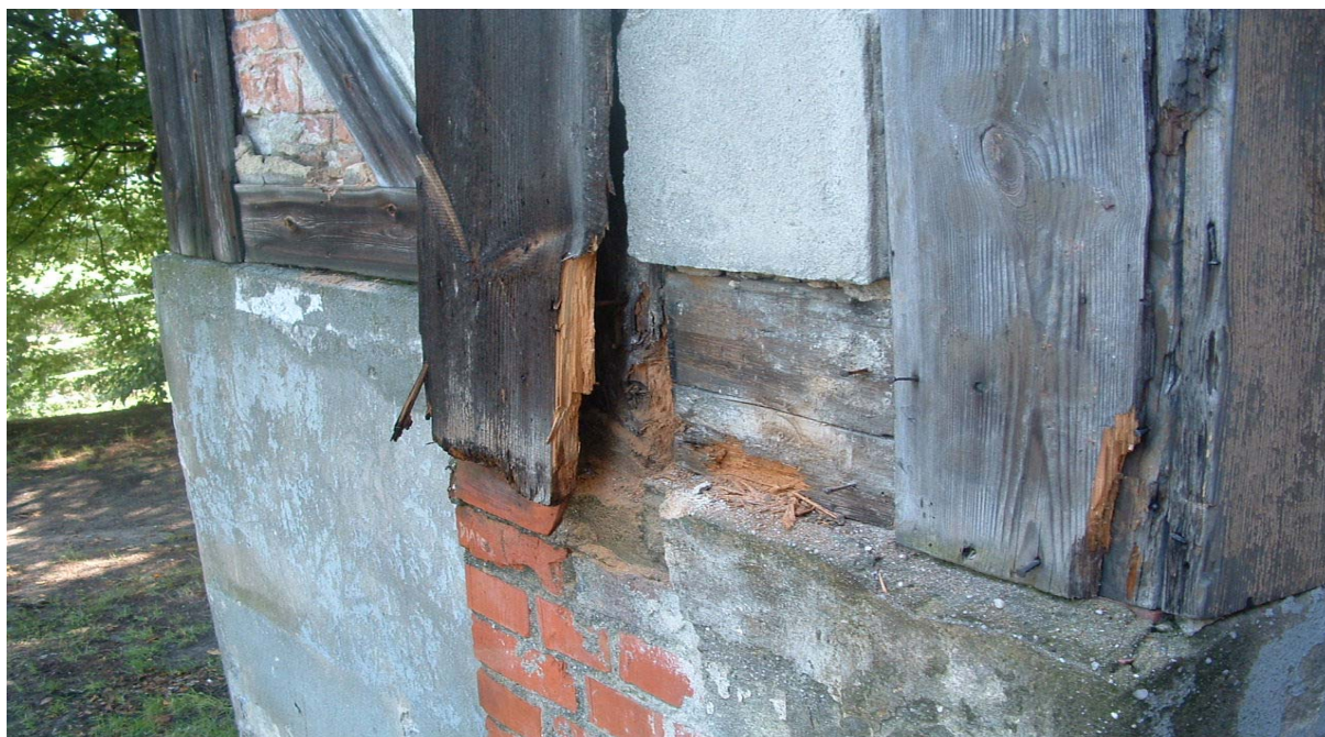
Zdjęcie Nr 5 –ślady korozji drewna przy ceglanej podmurówce.
