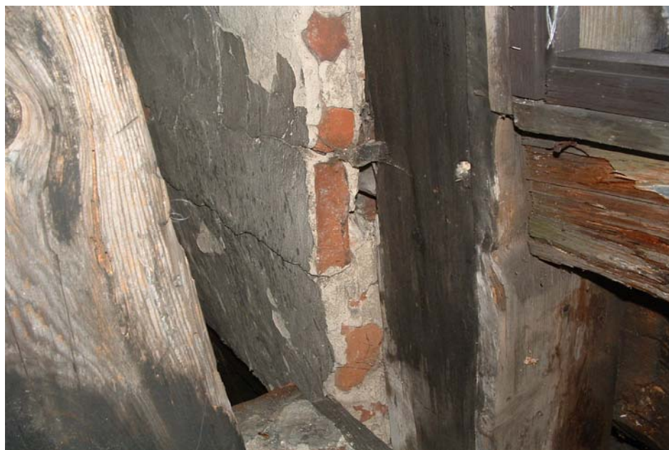
Zdjęcie Nr 9 – zniszczone, rozsypujące się ceglane wypełnienie „muru pruskiego” na poddaszu dzwonnicy.
