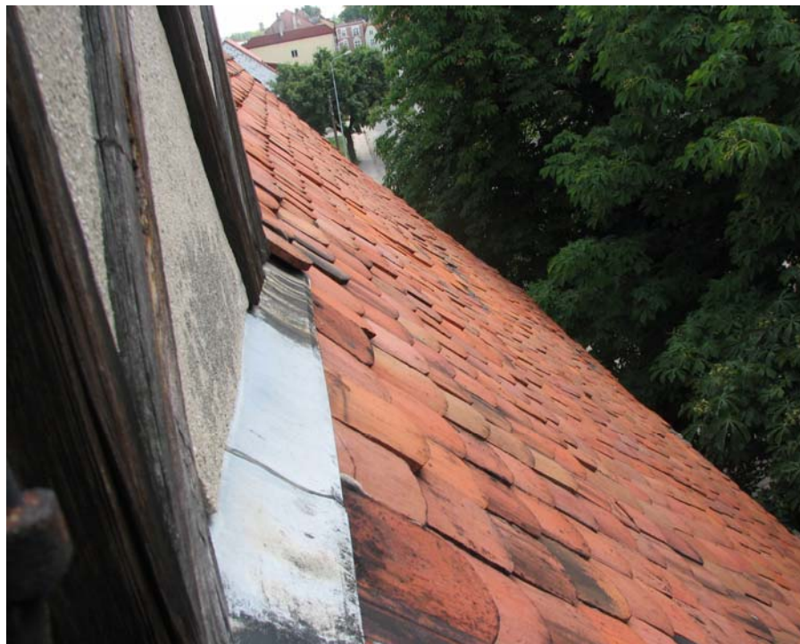
Zdjęcie nr 13 – stan dachówki nawy głównej oraz obróbki blacharskiej na styku z wieżą dzwonnicy.
