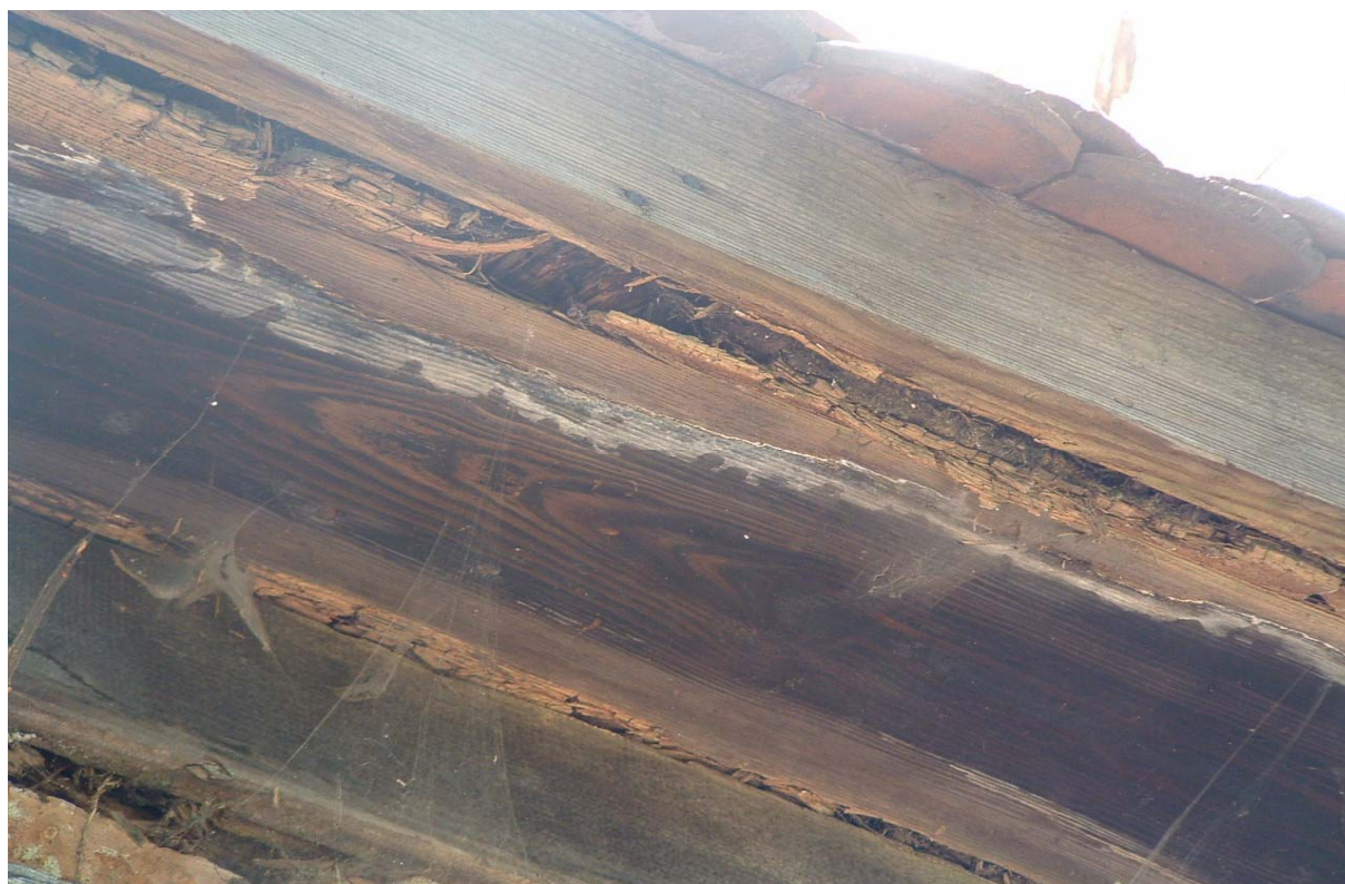
Zdjęcie Nr 6 –ślady korozji drewna przy okapie
