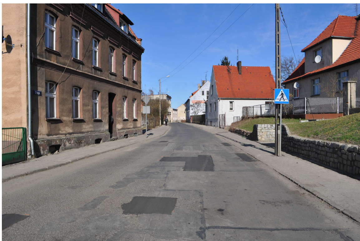
Droga gminna ul. Długa km 0+230 - stan techniczny nawierzchni widok od strony skrzyżowania z ulicami Grunwaldzką i Dąbrowskiego
