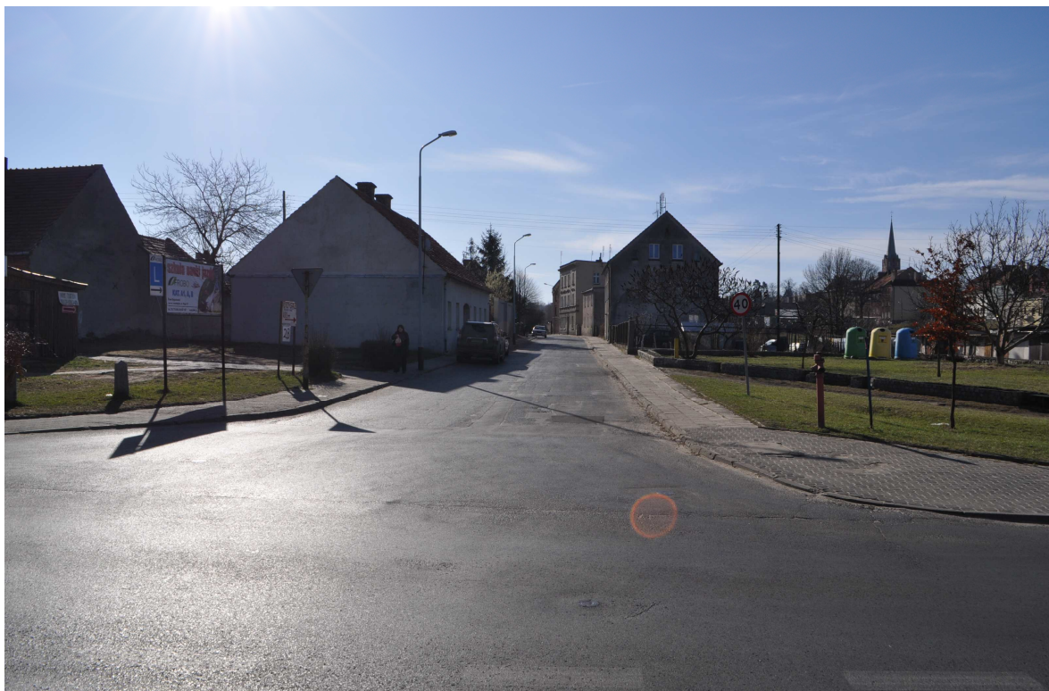
Droga gminna ul. Długa - P.P.T. Widok od strony drogi wojewódzkiej nr 448 - stan techniczny nawierzchni.
