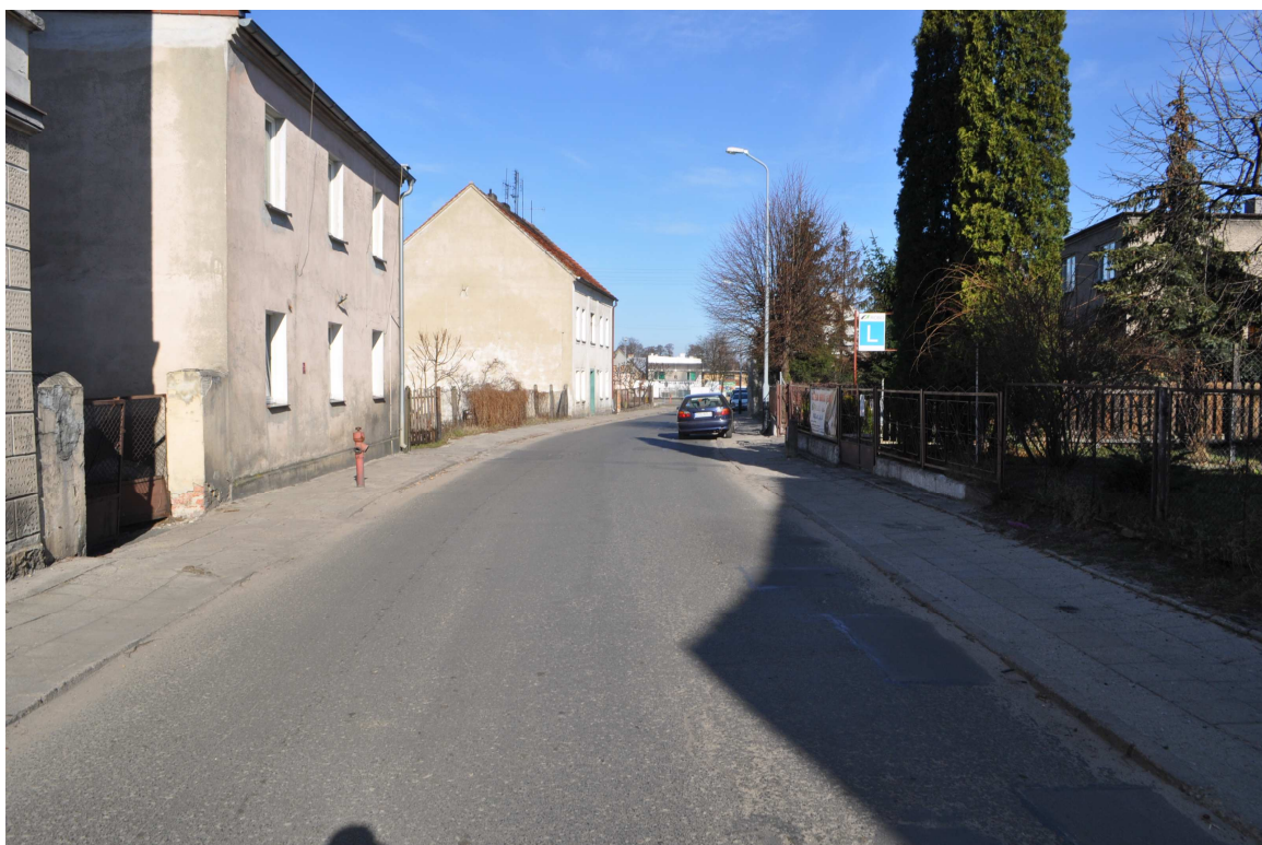
Droga gminna ul. Długa km 0+125 - stan techniczny nawierzchni widok w kierunku skrzyżowania z drogą wojewódzką nr 448
