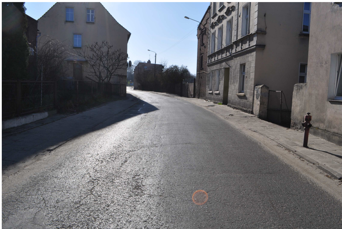
Droga gminna ul. Długa km 0+090 - stan techniczny nawierzchni widok w kierunku skrzyżowania z ulicami Grunwaldzką i Dąbrowskiego
