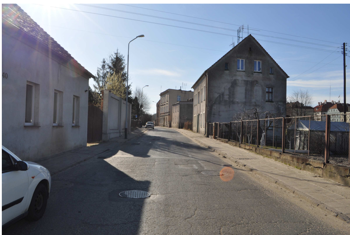
Droga gminna ul. Długa - stan techniczny nawierzchni
