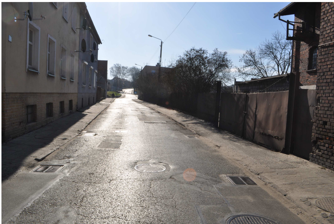
Droga gminna ul. Długa km 0+125 - stan techniczny nawierzchni widok w kierunku skrzyżowania z ulicami Grunwaldzką i Dąbrowskiego
