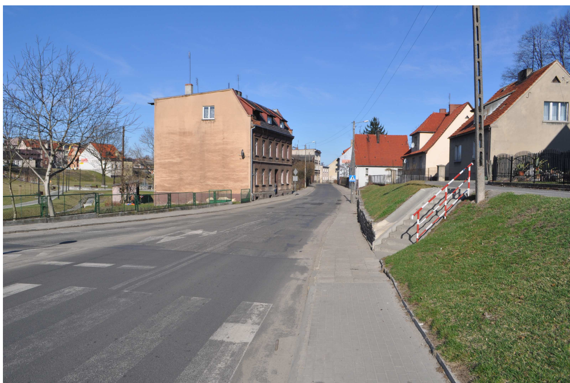
Droga gminna ul. Długa Koniec Projektowanej Trasy - stan techniczny nawierzchni
