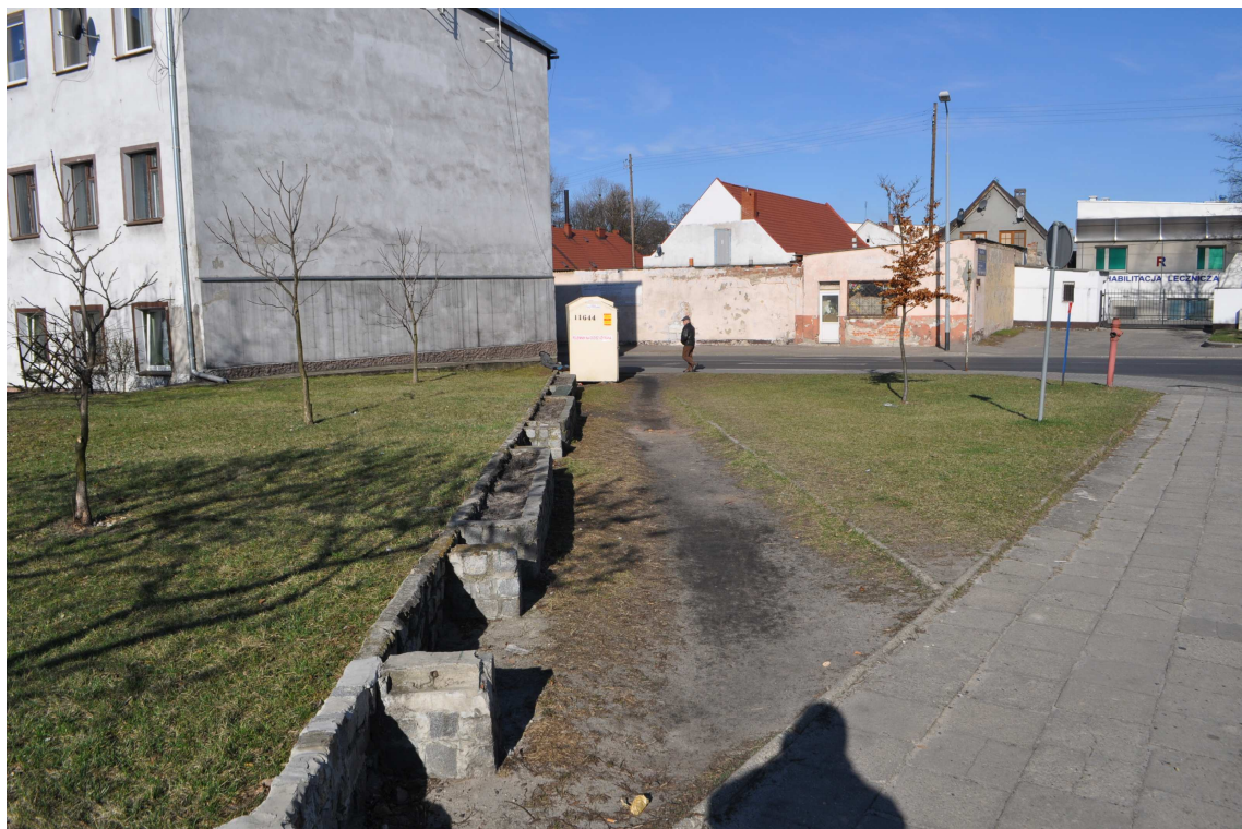
Teren zielony przy ul. Długiej strona prawa - stan techniczny nawierzchni
