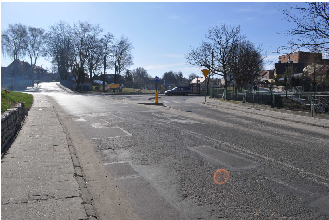
Droga gminna ul. Długa km 0+250 - stan techniczny nawierzchni widok w stronę skrzyżowania z ulicami Grunwaldzką i Dąbrowskiego
