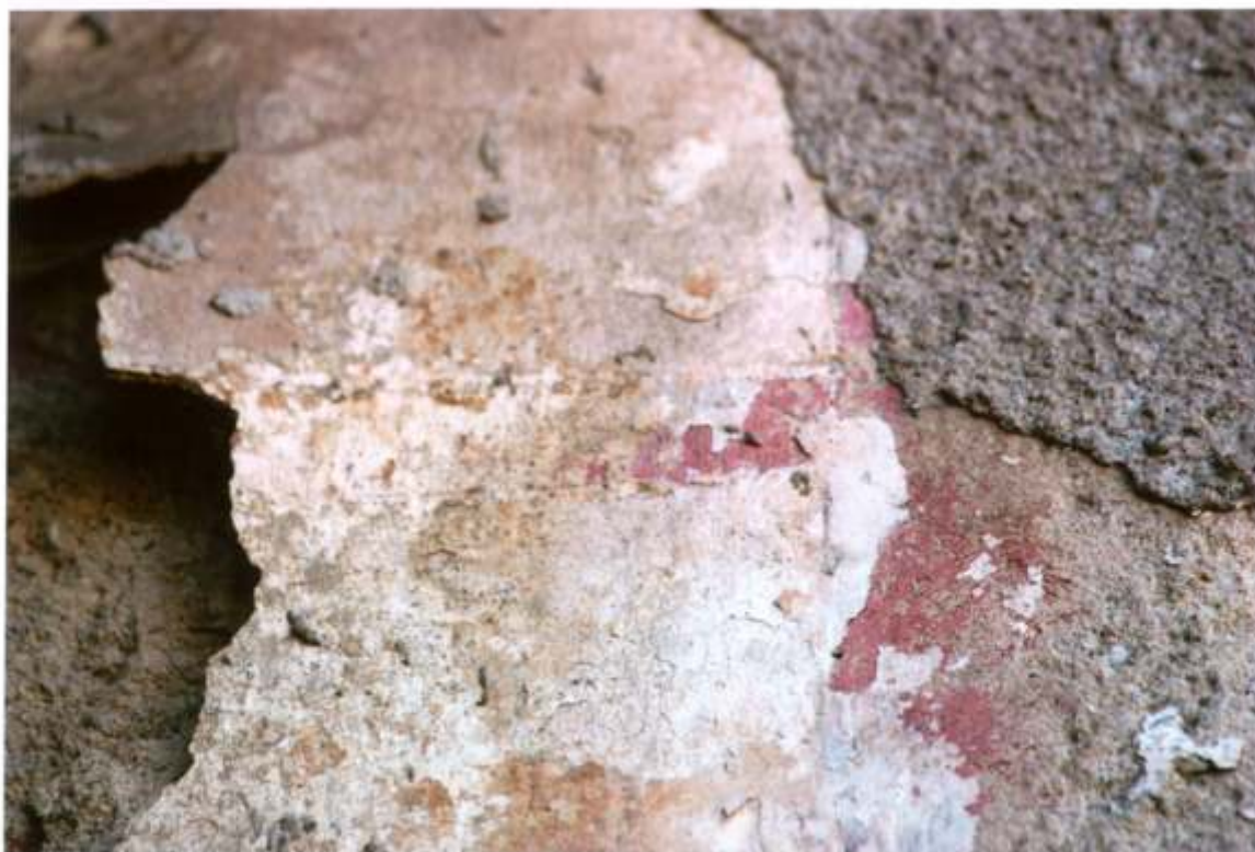
FOT. 33 - Goszcz, zespół pałacowy, skrzydło południowo – wschodnie, oficyna, detal fot. 30. W tynku pierwotnym widoczne rwy poziome i pionowe oraz naprzemienna kolorystyka biała i czerwona.
