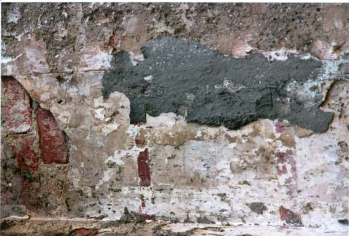
FOT. 32 - Goszcz, zespół pałacowy, skrzydło południowo - wschodnie, oficyna, detal fot. 30. W tynku pierwotnym widoczne ryty poziome i pionowe oraz naprzemienna kolorystyka biała i czerwona. ←
