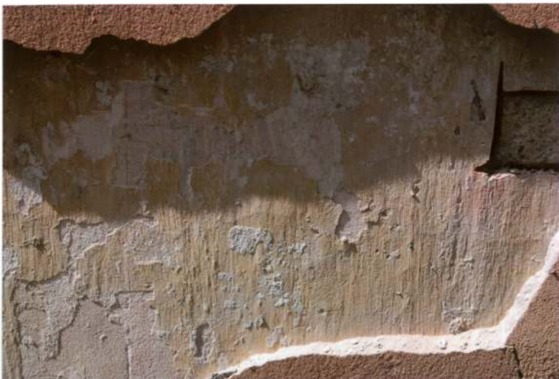
FOT. 11 - Goszcz, zespół pałacowy, skrzydło północno – zachodnie. Stajnia koni wyjazdowych, elewacja południowo – wschodnia, detal fot. 10. Nawarstwienia technologiczne z widocznym rytym tynku pierwotnej dekoracji malarskiej. Miejsce pobrania próbki.
