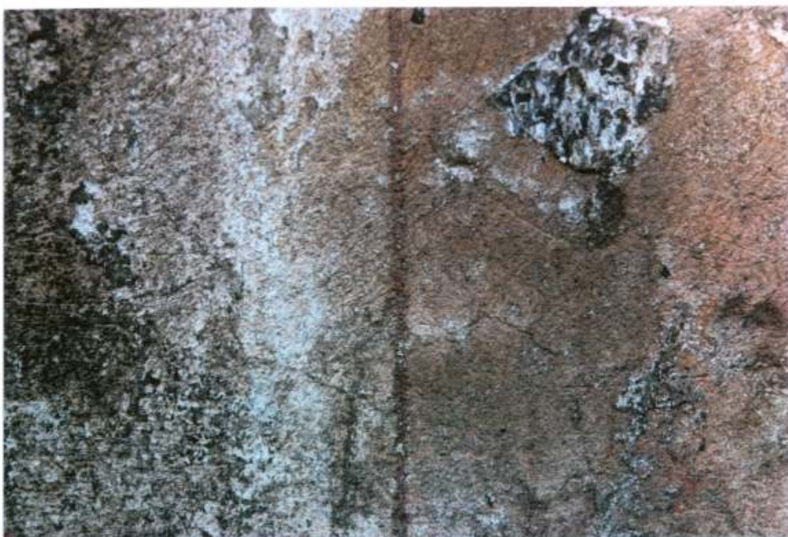
FOT. 21 - Goszcz, zespół pałacowy, skrzydło północno - zachodnie. Stajnia koni wyjazdowych, elewacja południowo - wschodnia, detal fot. 20. Odkrywka z widoczną kolorystyką i rytmem w tynku.
