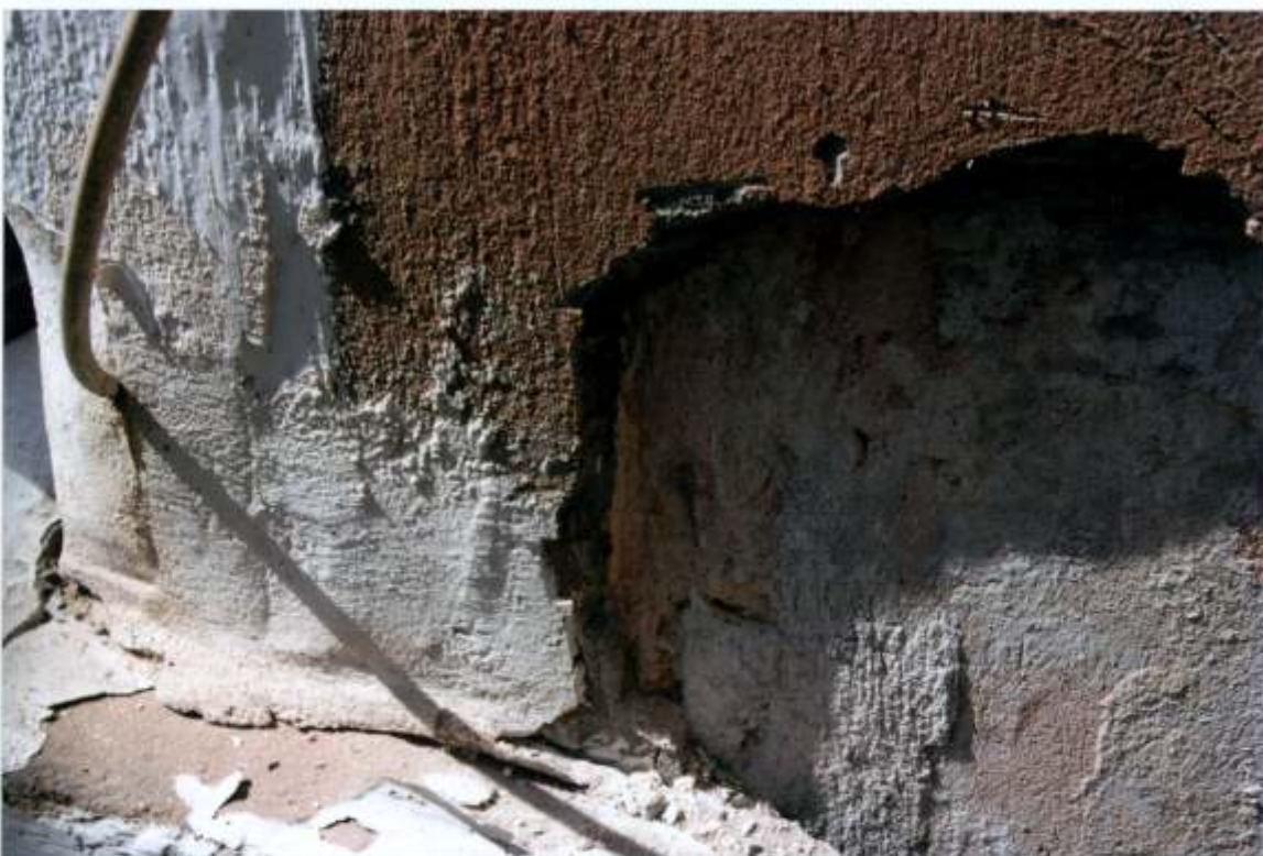
FOT. 8 - Goszcz, zespół pałacowy, skrzydło północno – zachodnie. Stajnia koni wyjazdowych, elewacja południowo – wschodnia, detal fot. 7. Odkrywka na granicy zewnętrznej krawędzi pierwotnej opaski okiennej.
