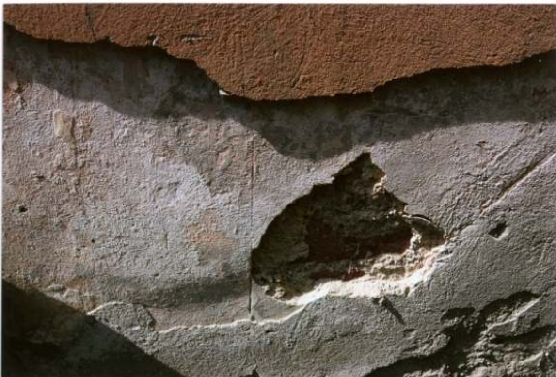
FOT. 9 - Goszcz, zespół pałacowy, skrzydło północno – zachodnie. Stajnia koni wyjazdowych, elewacja południowo – wschodnia, detal fot. 7. Przy ubytku tynku pierwotnego pionowa kreska – ryt w tynku oddzielający dwa pola barwne dekoracji malarskiej elewacji.
