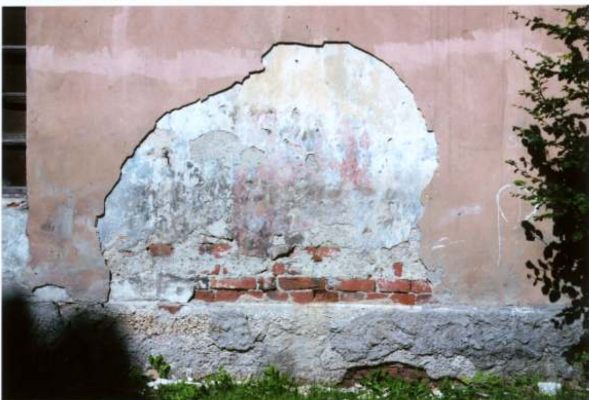
FOT. 18 - Goszcz, zespół pałacowy, skrzydło północno – zachodnie. Stajnia koni wyjazdowych, elewacja południowo – wschodnia, fragment. Odkrywka przy oknie VII osi od północy. Widoczna pierwotna kolorystyka czerwona z białym pasem pionowym (bliżej okna).
