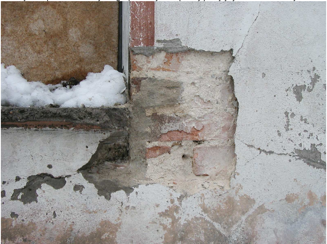
2. Odkrywka opaski okna i parapetu parteru byłego maneżu brak kamieniarki i brak negatywu opaski .
