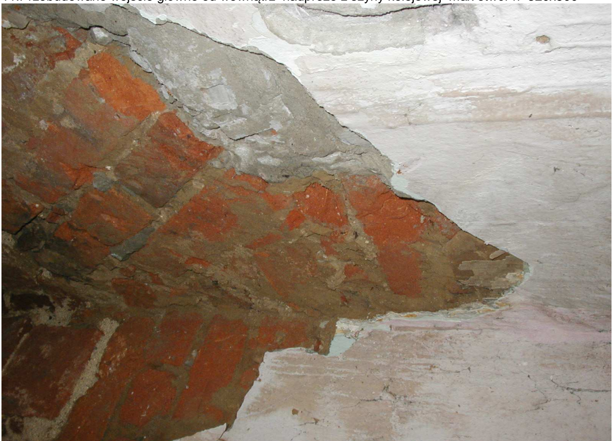
12.Zwierzaly tynk w sali z podłami brak malowideł pod tynkiem wiązanie ścian w jednym wątku
