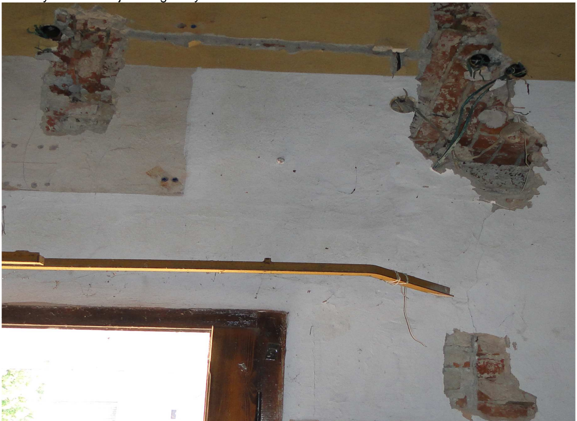
4. Ślady przemurowania przesklepionego łukiem wejścia głównego do maneżu
