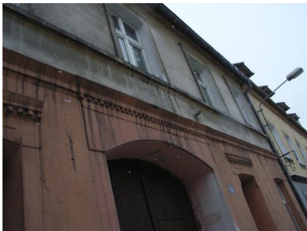
zabrudzenia elewacji frontowej
