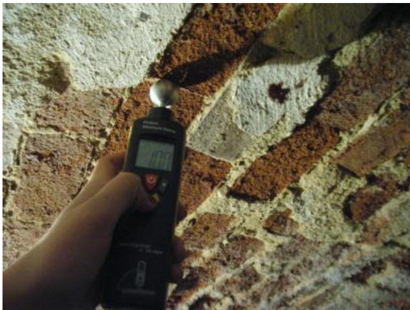
zawilgocenie ścian piwnic
