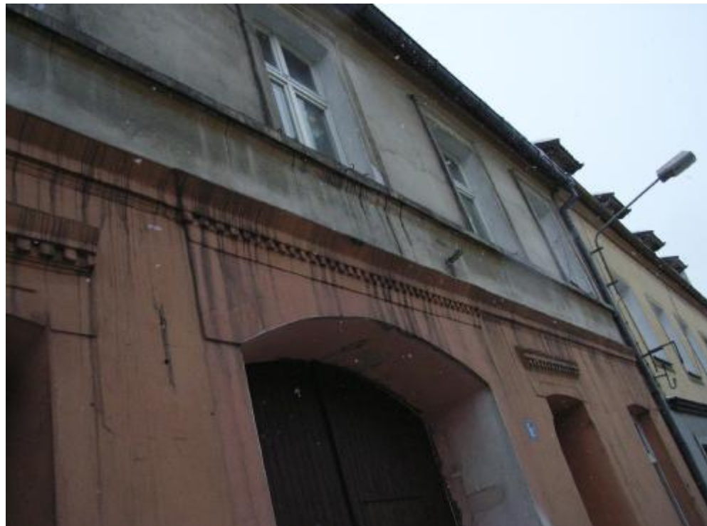
zabrudzenia elewacji frontowej
